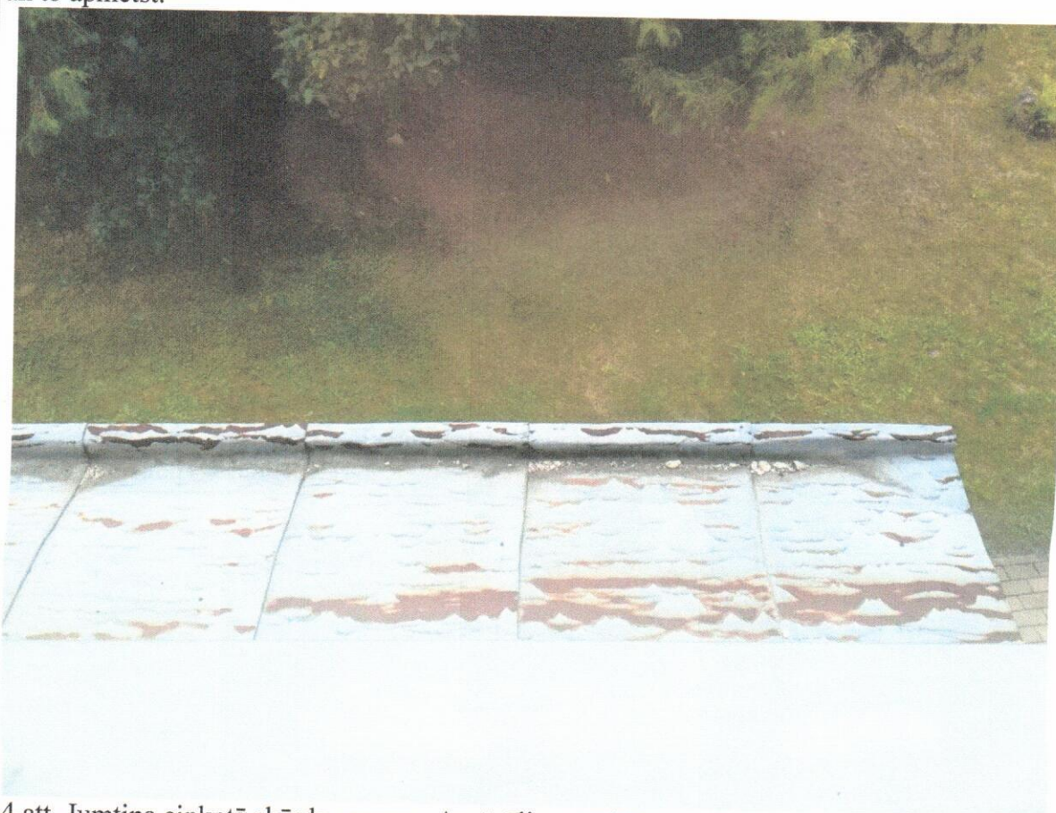
24.att. Jumtiņa cinkotā skārda segums. Aprūsējis, cauri sūcas mitrums.
