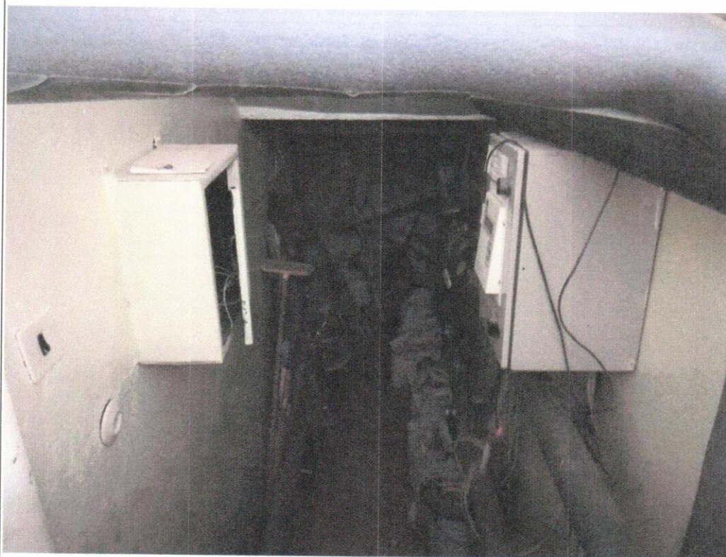
49.att. Elektroapgādes un ūdensapgādes ievada mezgls, elektrosadale cokolstāva patrepē ēkas rietumu daļas ieejā.
