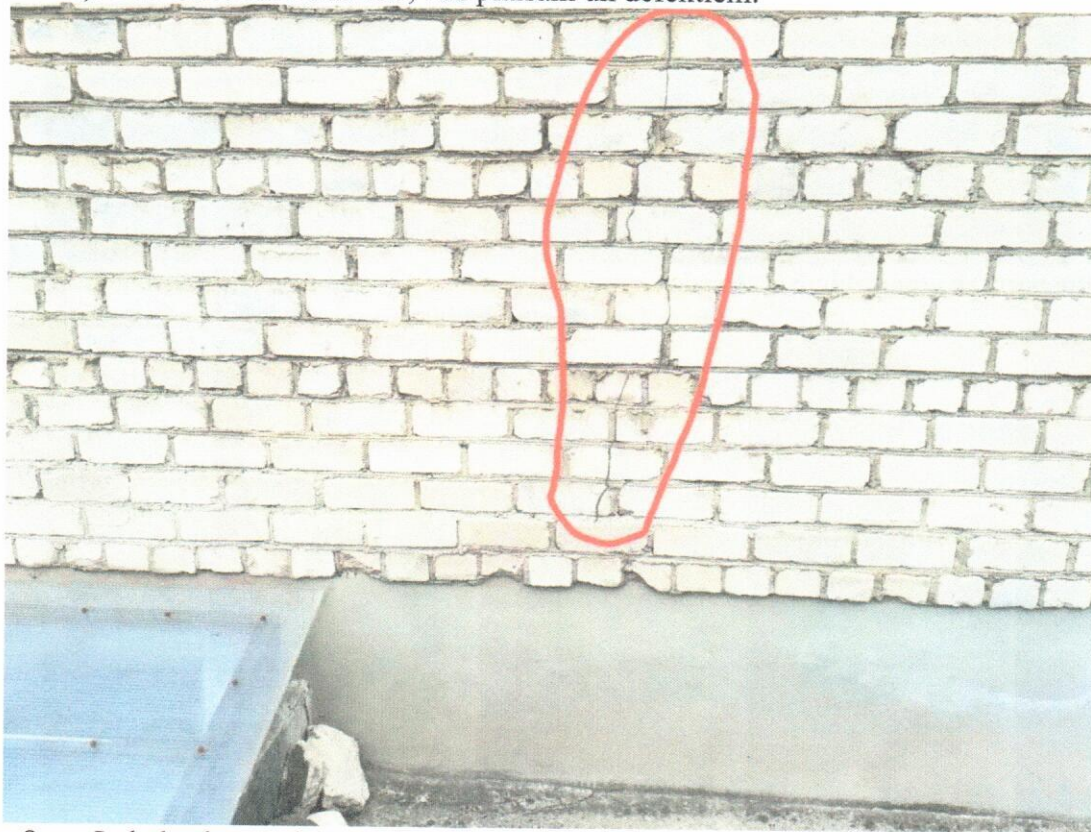
8.att. Lokāla sienas plaisa pagalma garesienai. Zem sienas cokols ir apmests un remontēts. Plaisa pamatiem konstatēta netika.
