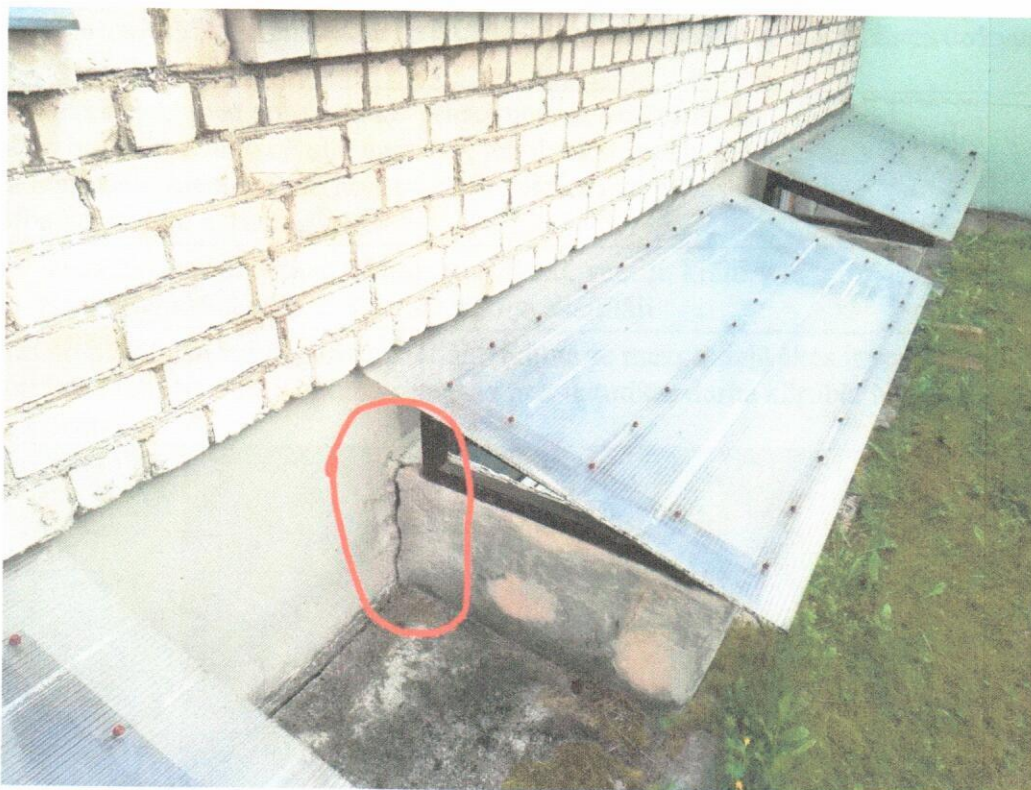
46. att. Betonēta ēkas apmale. Pagraba logiem izbūvētas betonētas bedres, nosegtas ar caurspīdīgām polikarbonāta loksņēm. Gandrīz visām cokolstāva logu betonētajām bedrēm ir atdalījies betonējums no pamata.
