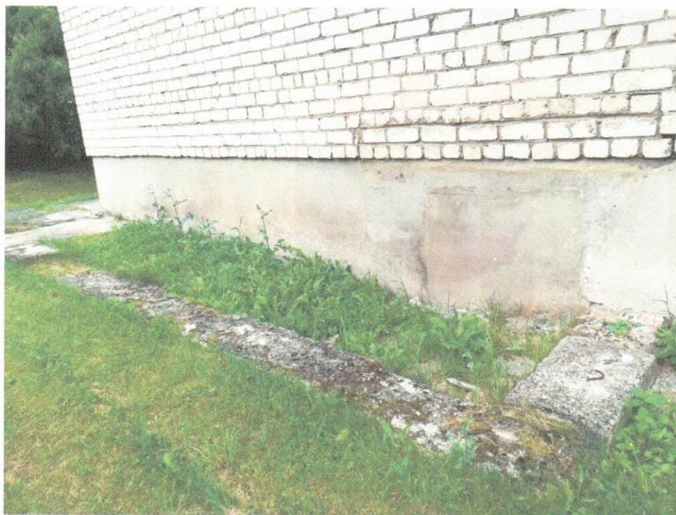
35.att. Aizmūrētas durvis ēkas ZA galasienā uz ieeju cokolstāvā. Kāpņu bedre aizbērtā.
