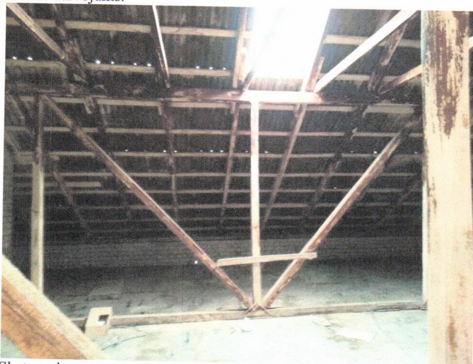
20.att. Skats uz jumta segumu no bēniņiem ar redzamu jumta logu un jumta krēslu. Redzami regulāri caurumi jumta seguma plākšņu pārlaiduma vietās, kas liecina par nepietiekamu pārlaidumu un montāžas instrukcijas neievērošanu.
