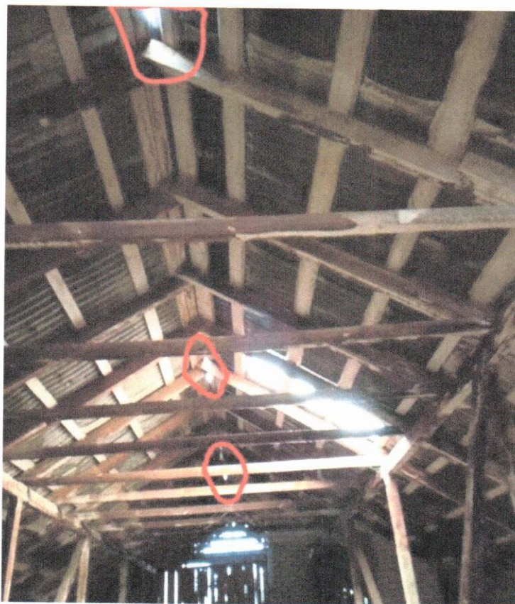
18.att. Ēkas jumta konstrukcijas kopskats. Jumta korei nav uzstādīti noslēguma elementi. Vertikālas spraugas jumta frontona dēļu apšuvumā.
