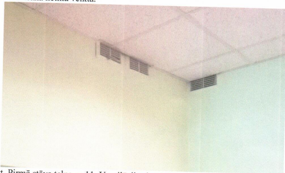
39.att. Pirmā stāva telpa nr.11. Ventilācijas kanāli neparādās inventarizācijas plānos.
