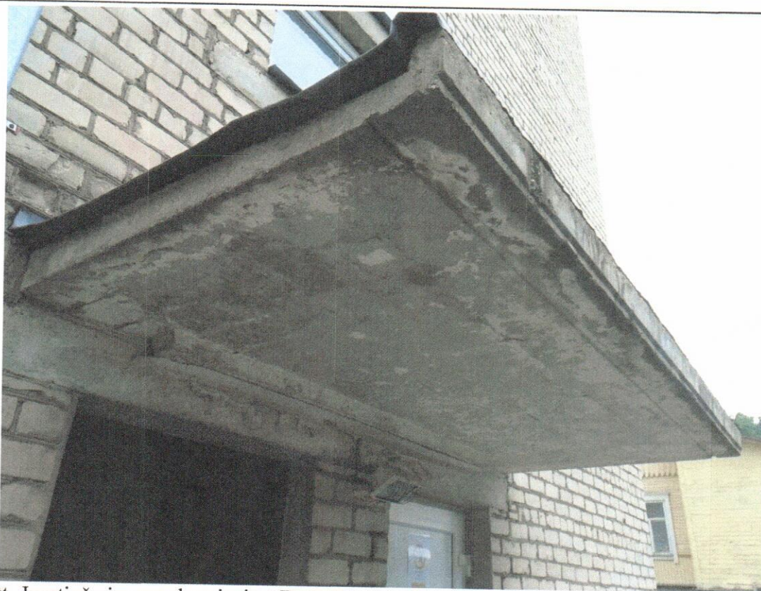
23.att. Jumtiņš virs pagalma ieejas. Betonam redzamas caurtecējuma pēdas. Atsegti divi stiegru fragmenti. Nepieciešams labot jumta segumu, attīrīt bojāto betonu, gruntēt armatūru un to apmetst.
