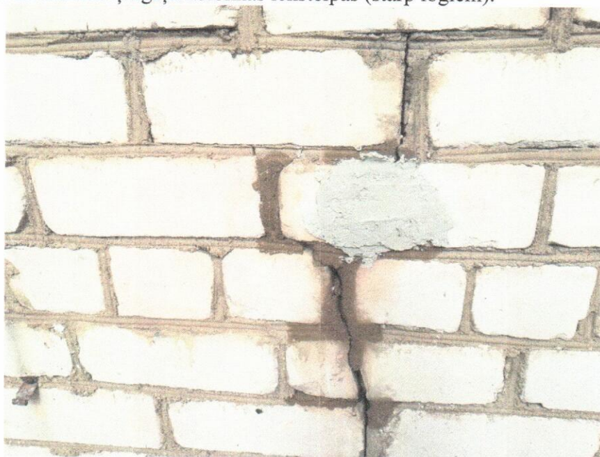
10.att. Uz plaisas ēkas DA puses gala sienai uzstādīta ģipša marka. Pēc divām nedēļām markai defekti netika konstatēti. Jāveic markas novērošana ilgtermiņā.
