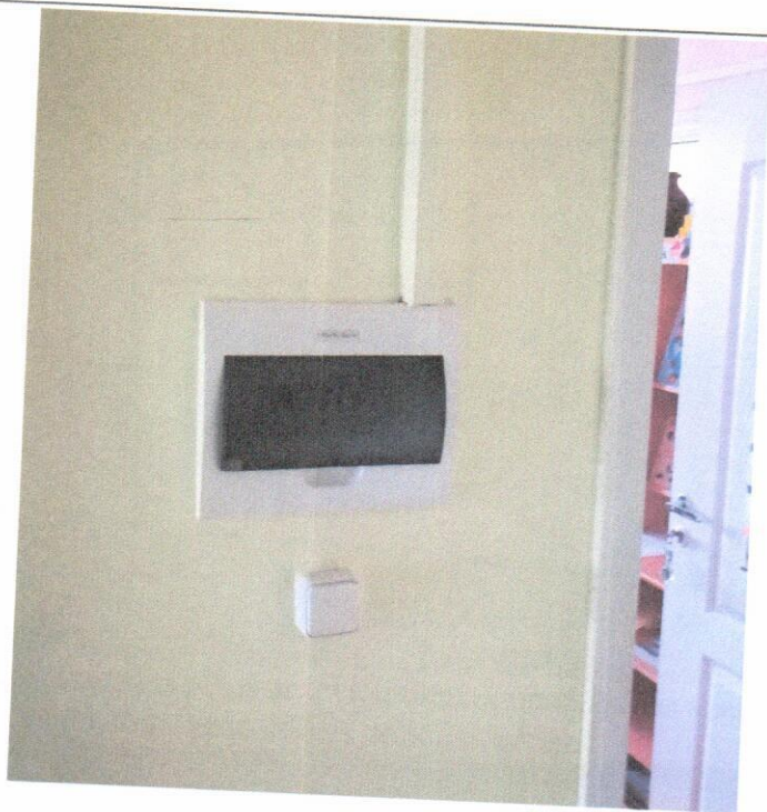
50.att. Lokāla elektrosadale ēkas 3. stāva gaitenī.
