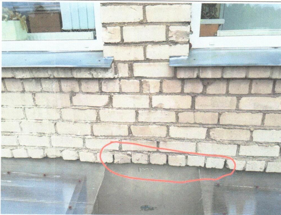
11.att. Sienas mūra izdrupumi, nepieciešamības gadījumā remontēt ar javu.
