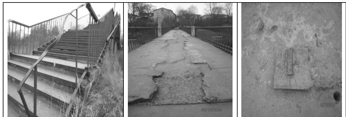
19.attēls. Gājēju pārejas lejasdaļā bojāts nožogojums
